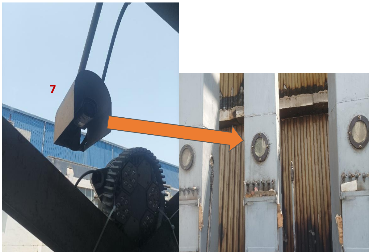
Figura 27. Cámara N°7 en Caldera
