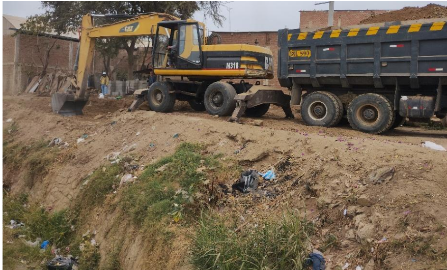
Figura 24. Calle Hipólito Unanue: Se observa suelo arenoso con presencia de salitre y restos orgánicos-basura
