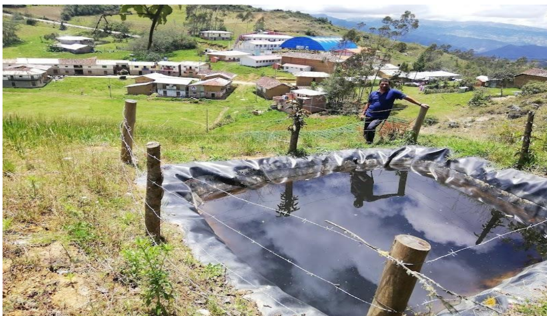
Figura 6: Pozo de agua con geomembrana
