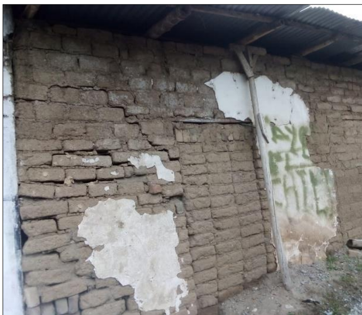
FIG 11.- Grietas en muros a punto de colapsar
