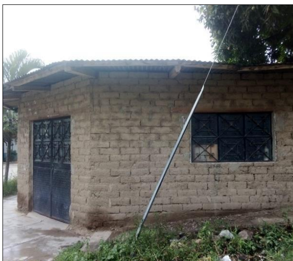
FIG. 12.- Presencia de humedad en primeras filas de adobe
