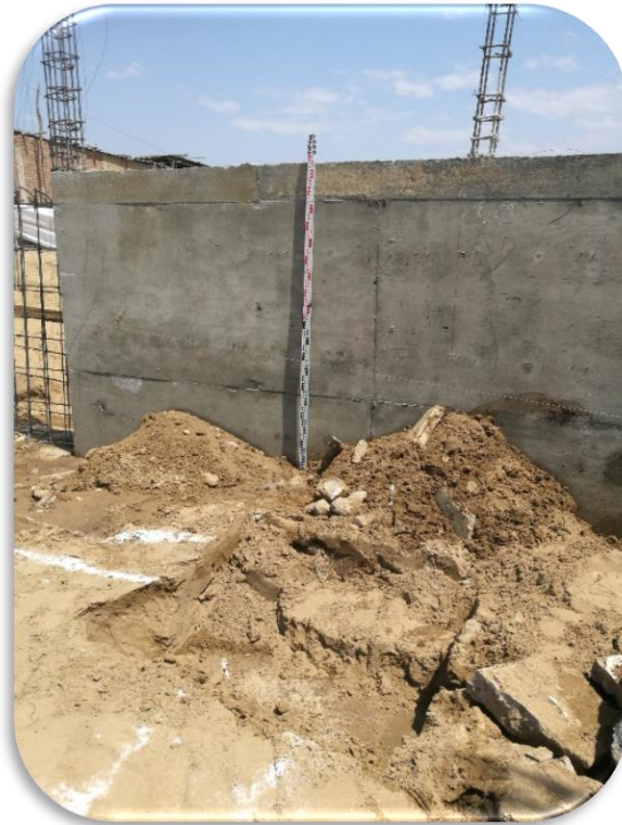
Imagen 19: En la imagen se puede apreciar la medida que deberá ser el relleno.
