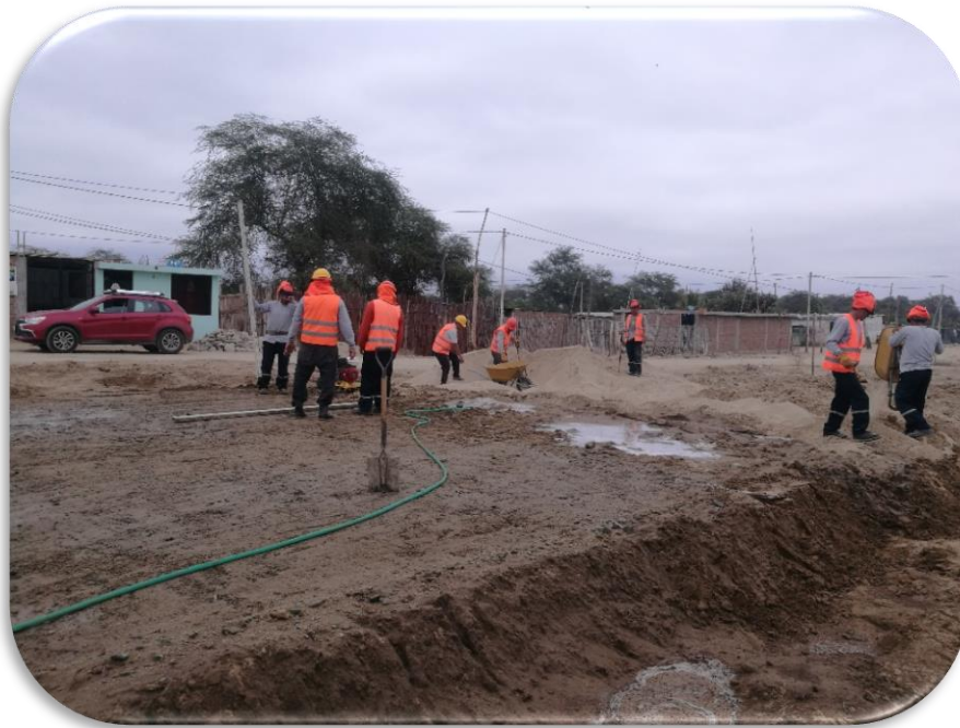
Imagen 02 y 03: Proceso de relleno y compactación En plataforma en aulas de contingencia.
