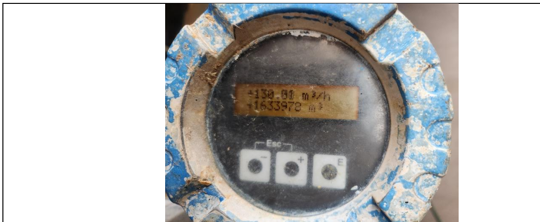
Figura 15. Lectura en el medidor de flujo en el Sistema DAF.
