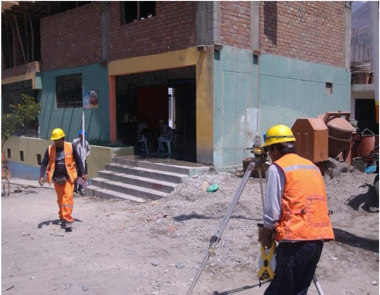
Figura I: Levantamiento Topográfico Del Nuevo Trazo Para La Propuesta Del Cambio De Distribución De Redes Permitió Cruzar La Vía Una Sola Vez En La Localiad De Catahuasi.
