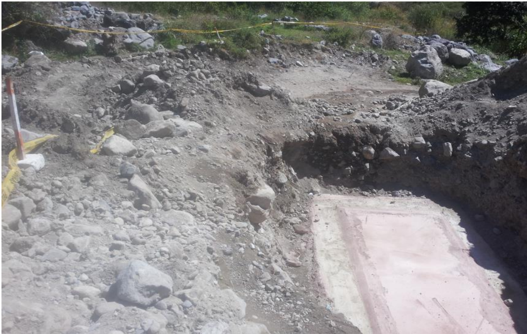
Figura N a 24 Obras del tanque septivo inconclusas
