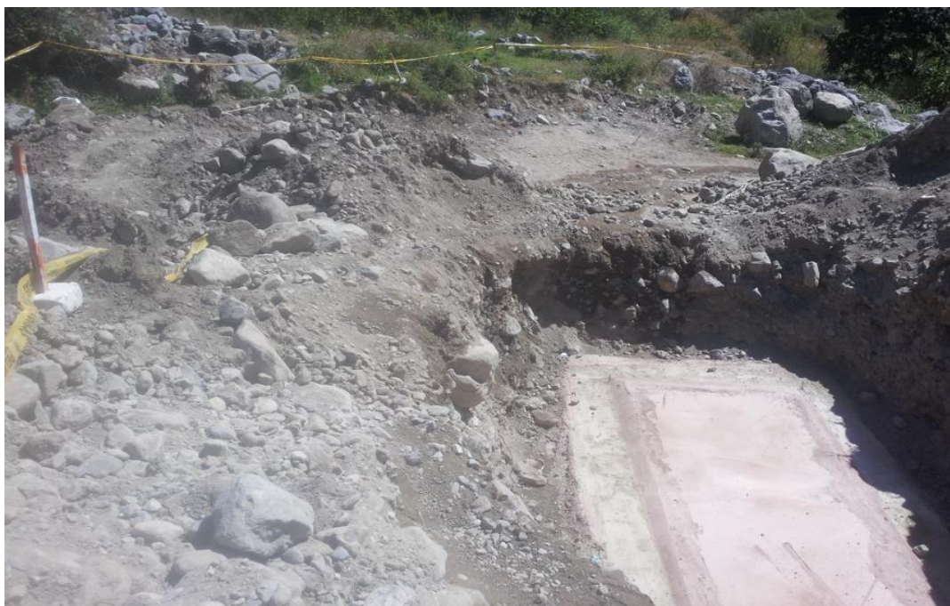
Figura N° 24 Obras del tanque séptico inconclusas
