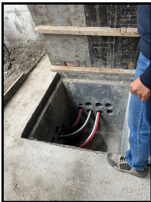
Fotografía 88 Cableado de buzón eléctrico, proveniente de sub estación 2 de pabellón de primaria baja
