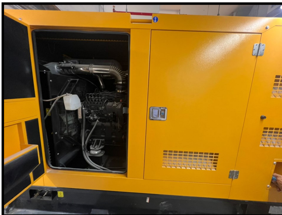
Fotografía 142 Se muestra grupo electrógeno en funcionamiento en el sótano 2
