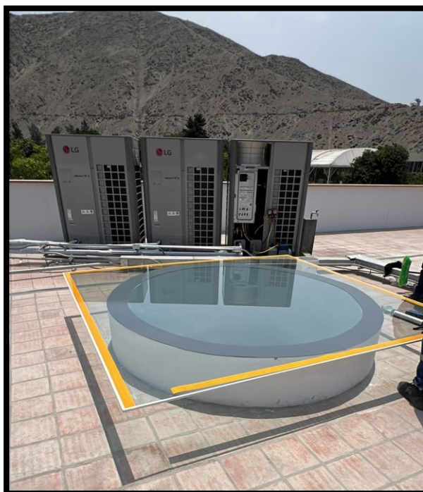
Fotografía 140 Se observan condensadores marca LG en azotea, al igual que el vidrio que cubre el lucernario de azotea generando un spot en sala de profesores de piso 2
