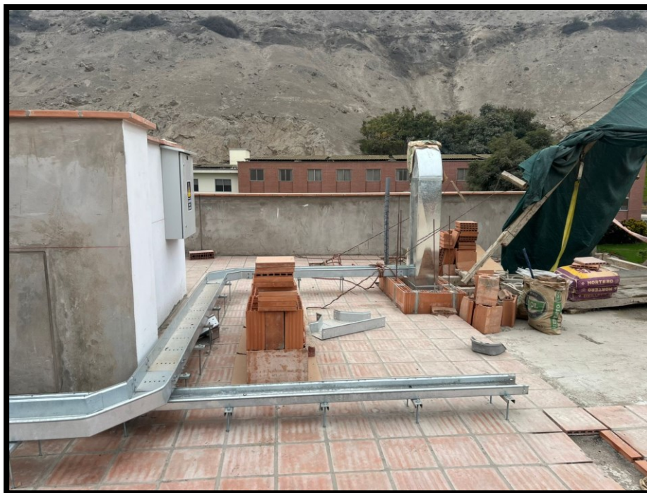
Fotografía 109 Vista de azotea, se puede observar colocación de tablero eléctrico, bandejas, ductería y enchape de piso con ladrillo pastelero
