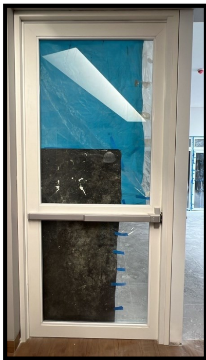
Fotografía 123 Se muestra puerta de aluminio y vidrio, con barra antipánico
