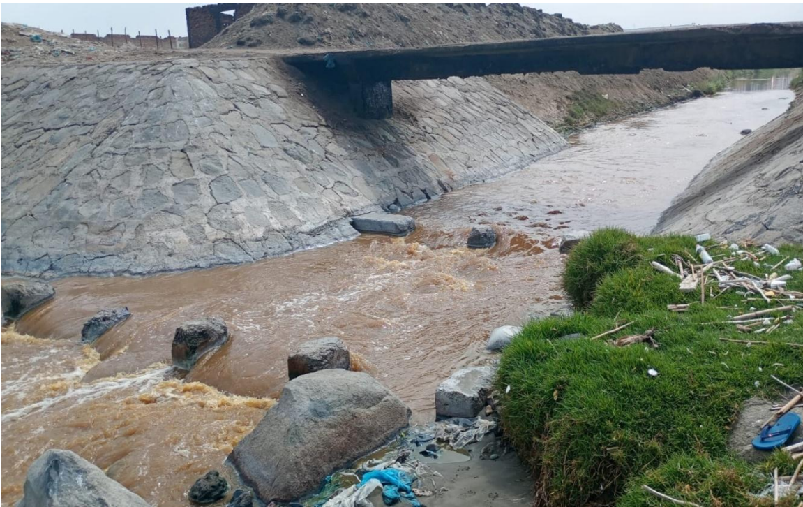
Figura 3: Desembocadura del Dren 4000.
