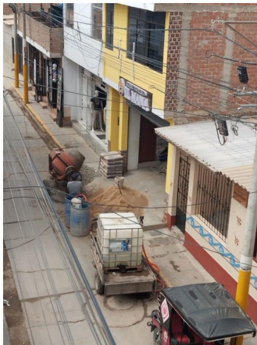
Fotografía 9: Concreto realizado en obra, sin dosificación correcta.
