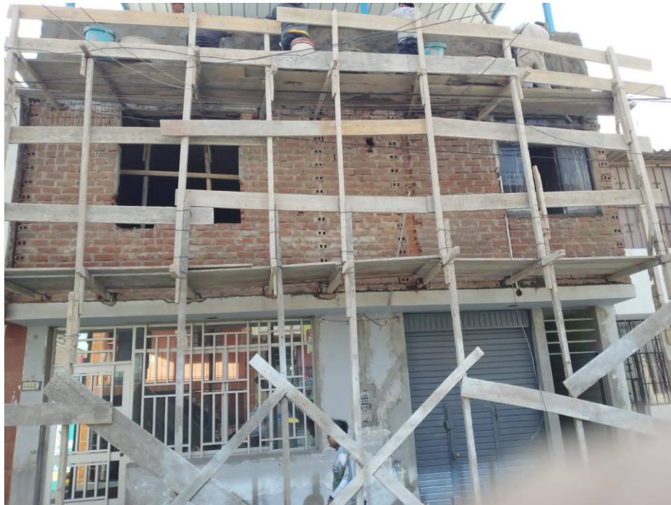
Fotografía 7: Muros portantes con ladrillo de poca resistencia.
