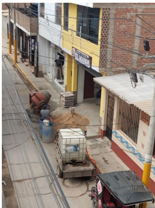
Fotografía 9: Concreto realizado en obra, sin dosificación correcta.
