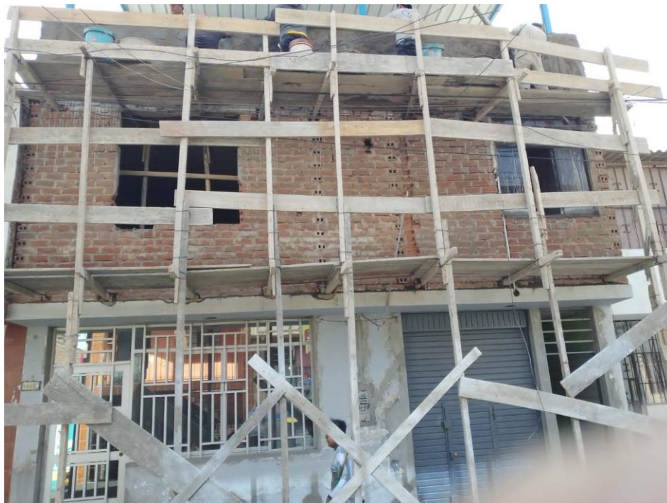
Fotografía 7: Muros portantes con ladrillo de poca resistencia.
