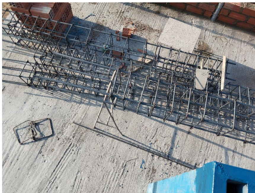
Fotografía 2: Acero en columnas con mala distribución.
