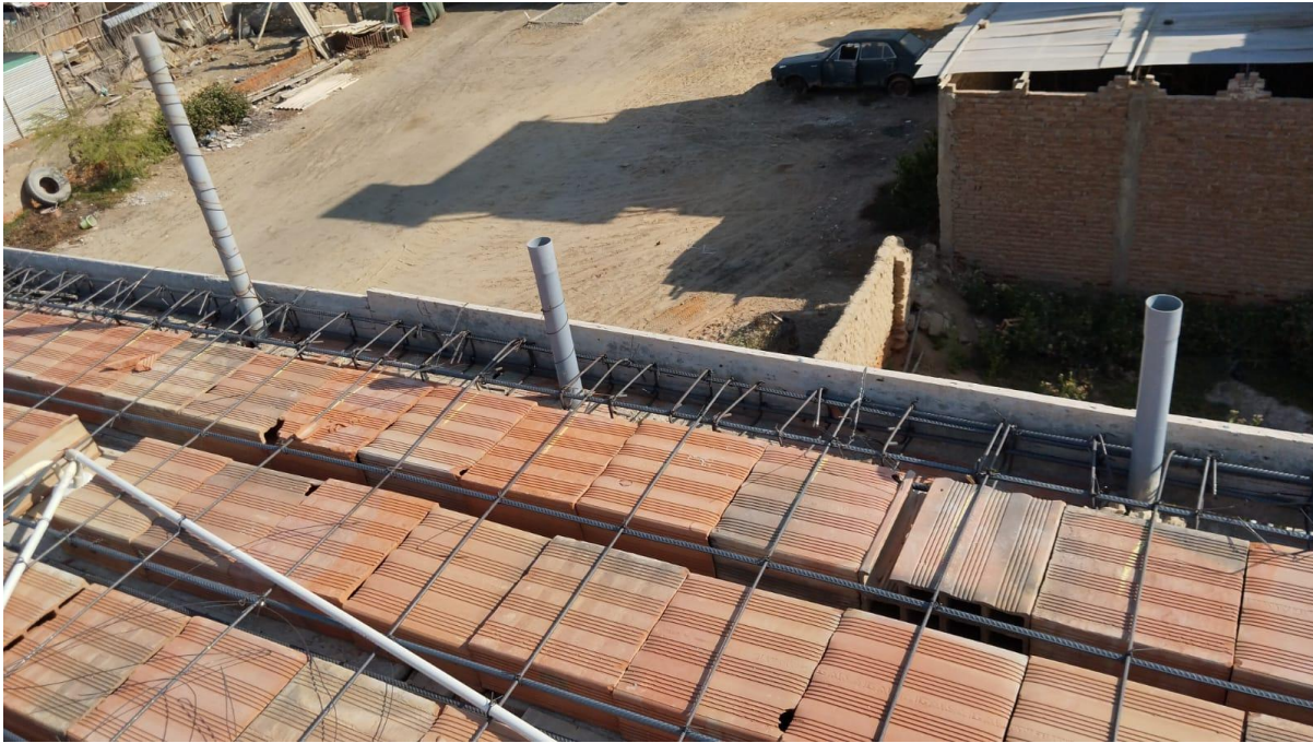
Fotografía 11: Ladrillos mal ubicados en losa aligerada.
