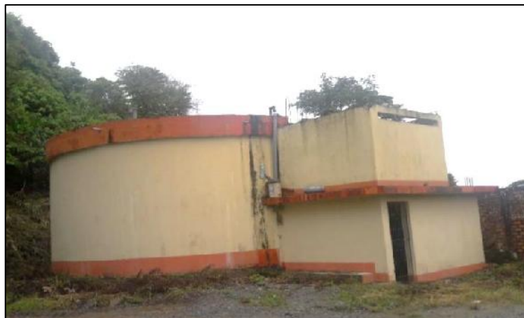
Figura 25. Reservorio inoperativo apoyado de 450 m 3 en mal estado
