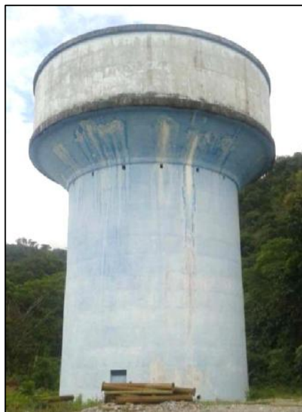
Figura 26. Reservorio elevado inoperativo de 1,300 m 3 en mal estado
