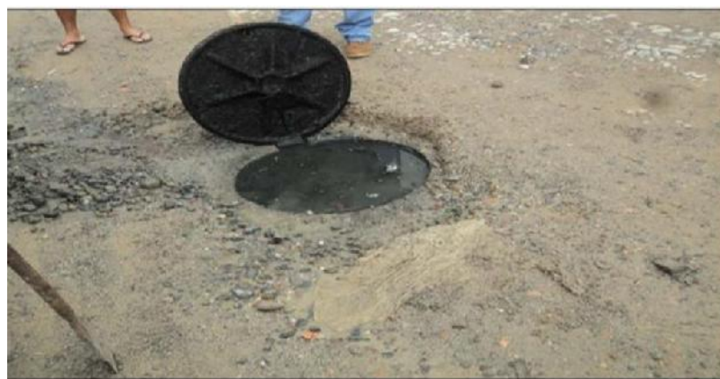
Figura 27. Buzón en estado de colapso
