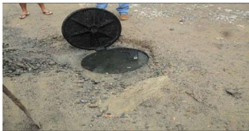
Figura 27. Buzón en estado de colapso
