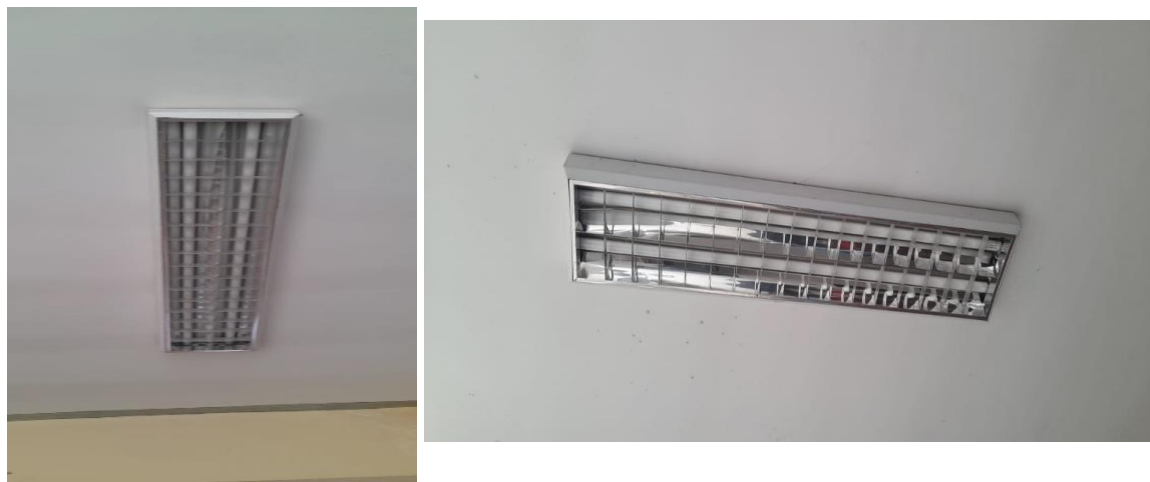
Figura 3: Evidencia de las luminarias instaladas en el Hospital Regional de Lambayeque
