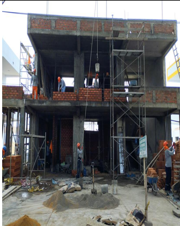
FOTOGRAFIA N°01: Asentamiento de muros de sogá
