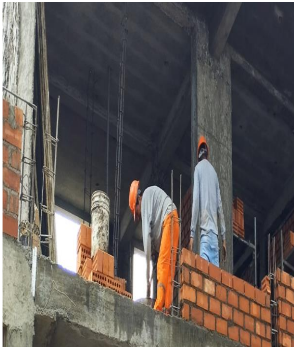
FOTOGRAFIA N°01: Asentamiento de muros de sogá
