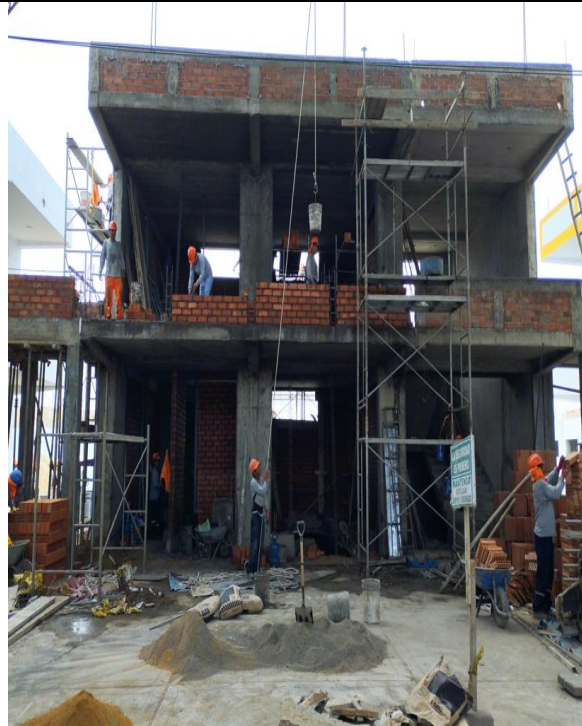
FOTOGRAFIA N°01: Asentamiento de muros de sogá
