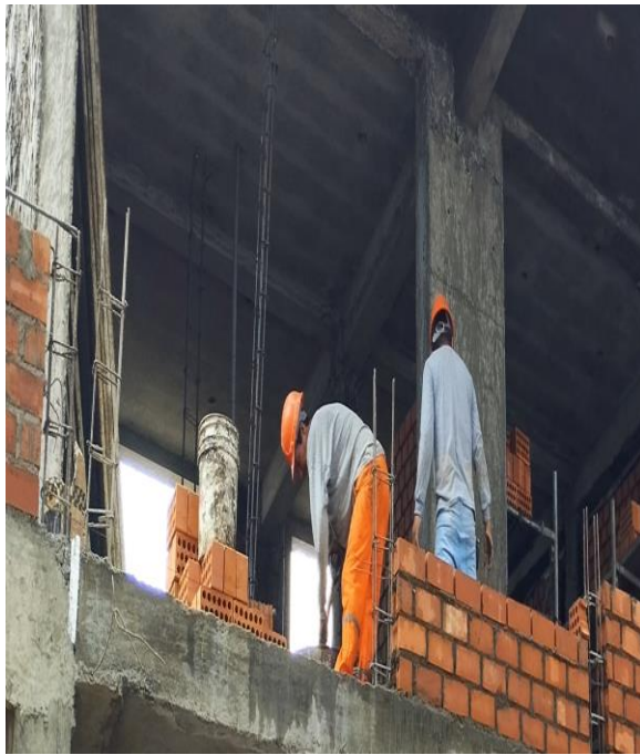
FOTOGRAFIA N°01: Asentamiento de muros de sogá
