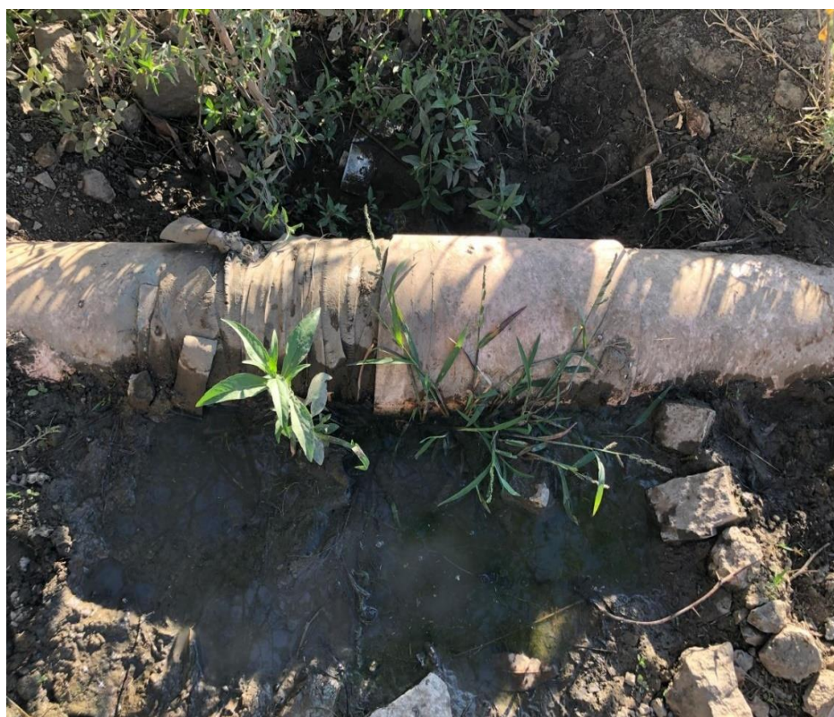
Fotografía 5. Perdidas por fugas visibles en las tuberías.
