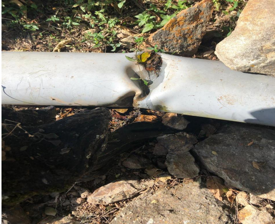
Fotografía 6. Perdidas por cambio de dirección de la tubería.
