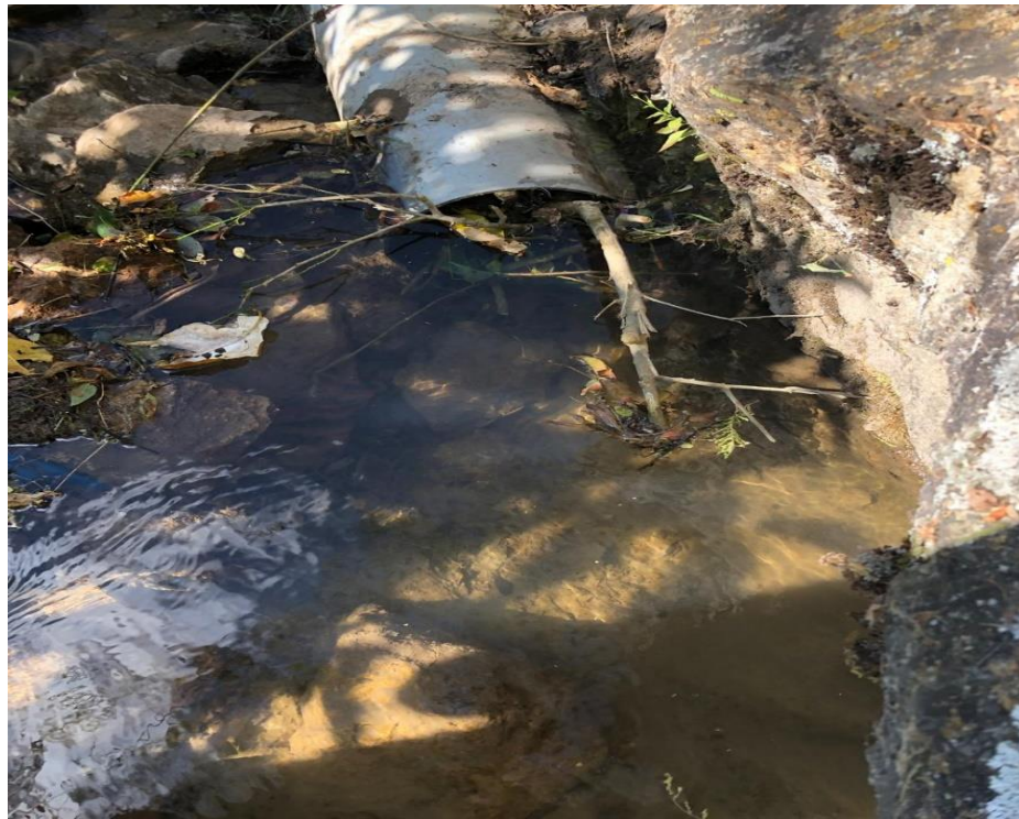
Fotografía 7. Obstrucción de tubería por hojas y ramas, que impide el flujo del agua, falta de mantenimiento.
