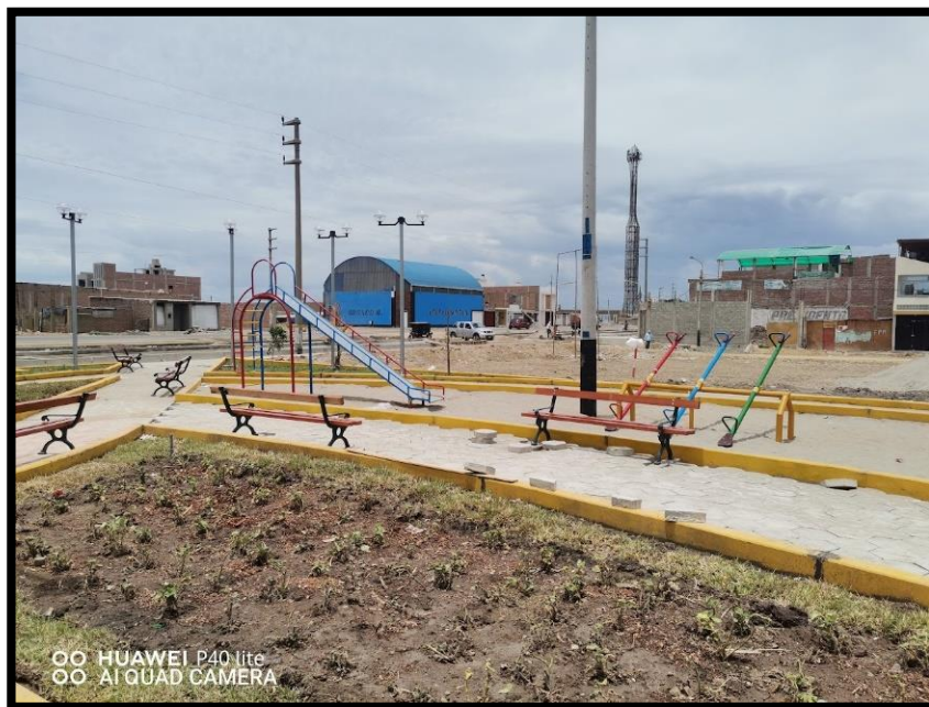
Foto N° 15: Verificación de la instalación de juegos infantiles
