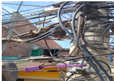
Cable independiente en los postes de luz
