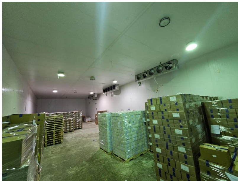
Figura 1. Cámara frigorífica 3 de la procesadora Perú S.A.C.
