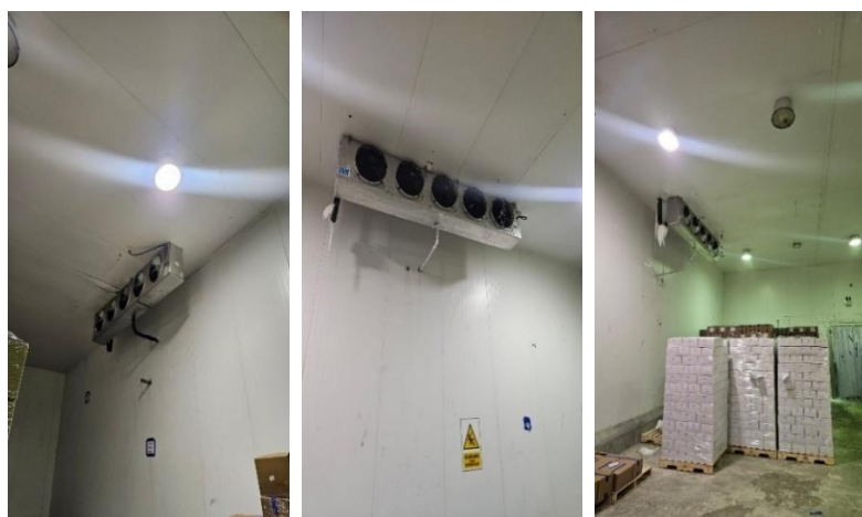
Figura 10. Evaporadores de las 3 unidades de la cámara 3.
