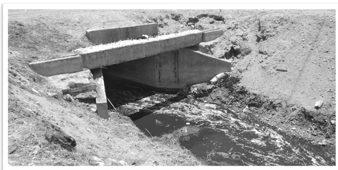
Figura 68: Dren 3100 totalmente contaminado, presencia de aguas negras en su trayecto.
