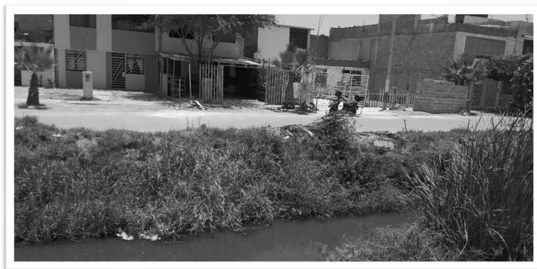
Figura 69: Dren 3100 totalmente contaminado, frente a Urb Las Dunas emanando olores fétidos.
